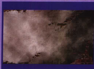
残损墙壁 (见第5章)
