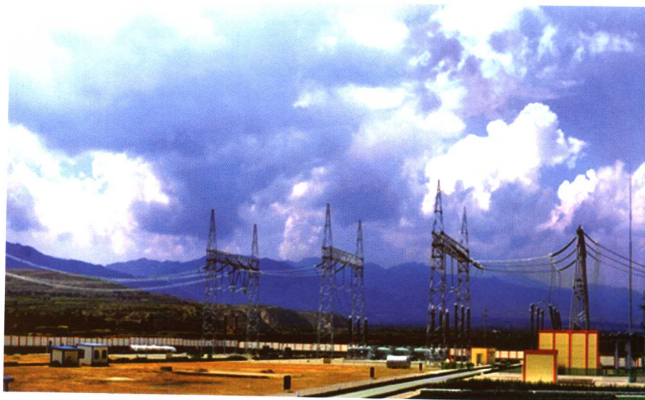
750千伏兰州东变电站全景。
