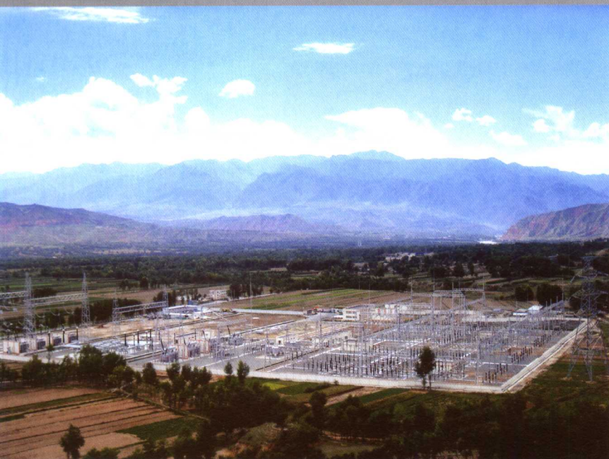
750千伏官亭变电站全景。
