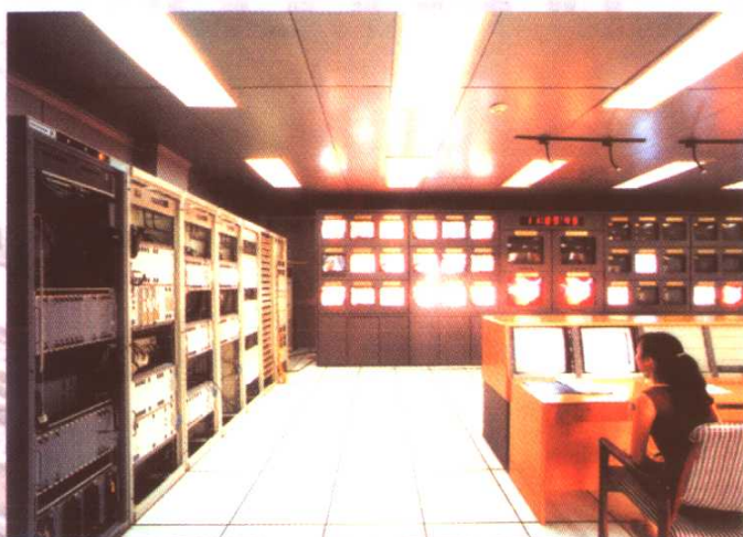
安徽广播电视厅SDH2.5G数字传输系统及电视监控系统
