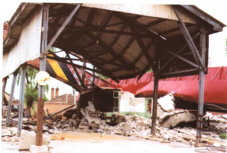
1991年6月8日，海淀区清河镇雷雨大风刮倒吊车砸坏泵房
