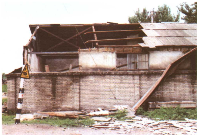
1991年6月8日，海淀区清河镇 雷雨大风掀掉屋顶
