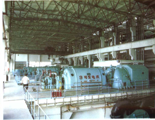
平桥电厂发电机组
