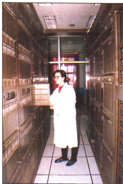
2. 县邮电局 7200 门程控电话机房
