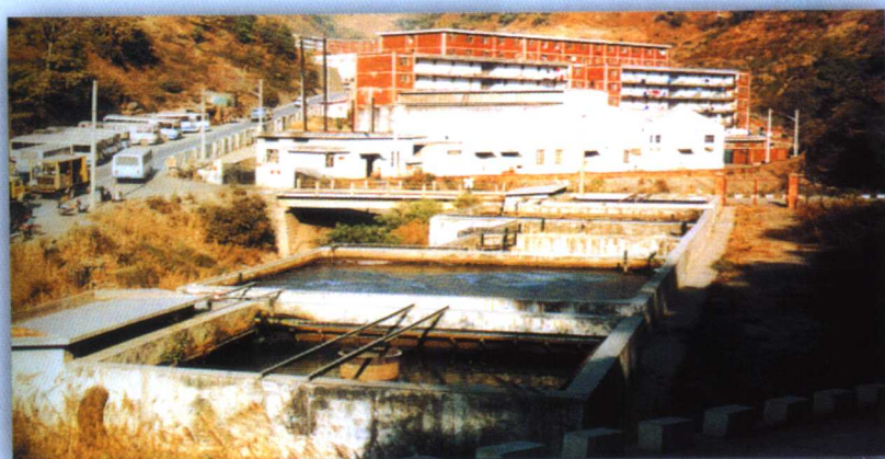
施工区污水处理系统
