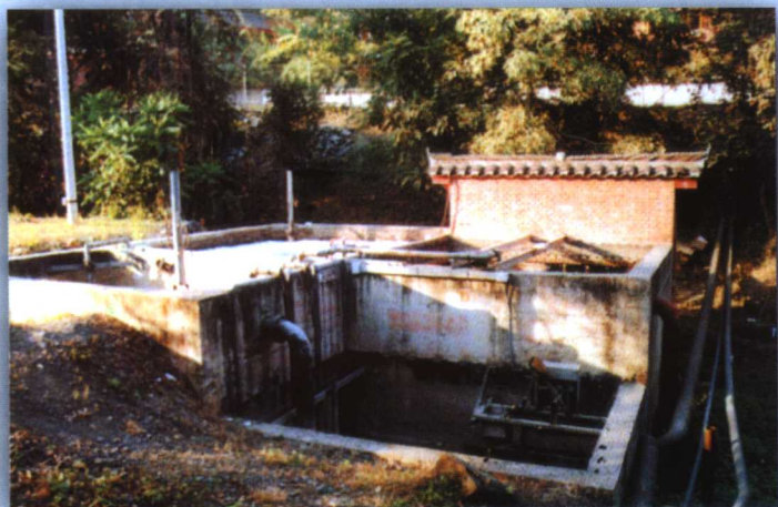
生活区污水处理设施
