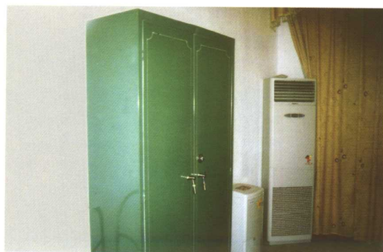
黔西南州房管局档案室一角(空调设备)
