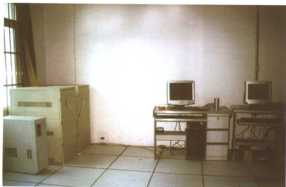
黔西南州房管局住房资金管理系统硬件设施(UPS8小时在线, Hp560服务器两台)
