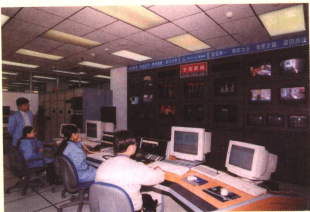
中央电台主控机房
