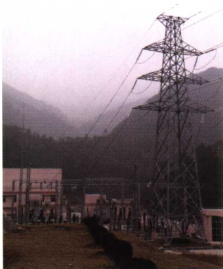
牛头山电站110kV升压站。
