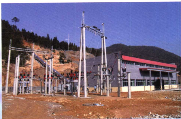
屏南县亭头港电站，原装机容量1600kW，2004年进行改建，利用原电站水库，新建引水隧洞和发电厂房，装机容量8000kW。图为即将投产发电的亭头港电站。
