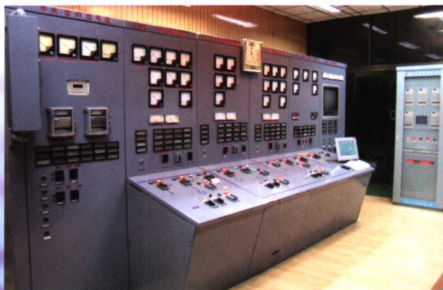
闽东电站中控室。
