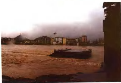
乐昌市主要公路桥——武江大桥被洪水冲塌。（童铜韶 摄）
