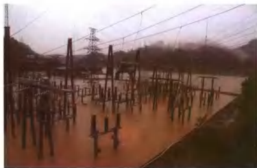
乐昌市坪石 110 千伏江湾变电站被淹。(黄远兴 摄)
