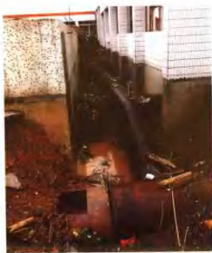
乐昌市自来水厂深埋地下1米多的输水管被洪水掀起，造成供水中断。（童铜韶 摄）
