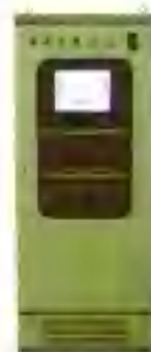
实验炉DCS控制系统:
