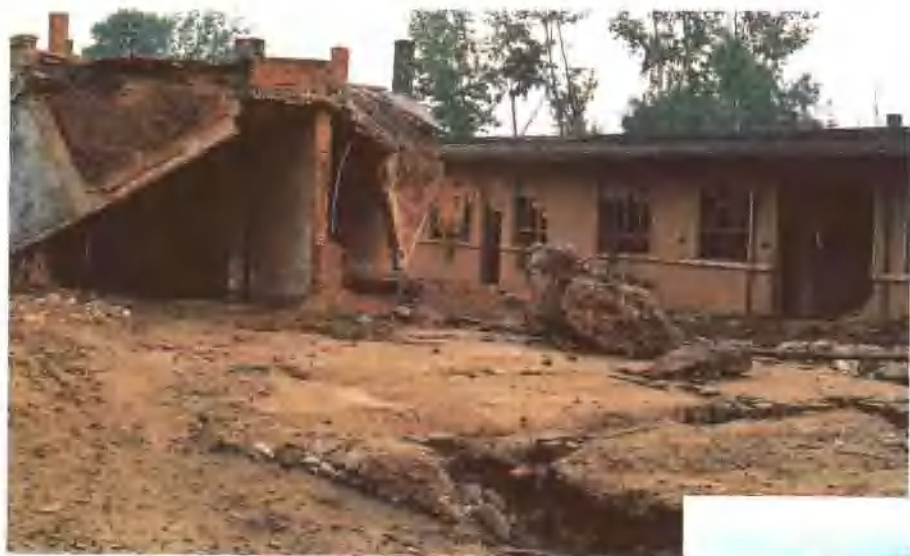
房屋被毁坏 (徐茂杰 摄)
