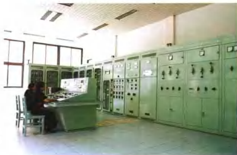
跳石头电站监控室
