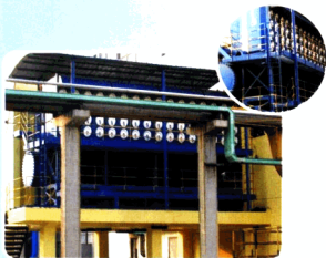
应用于某大型焦化厂压缩机前端
