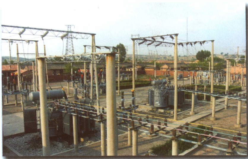
榆社110千伏变电站
