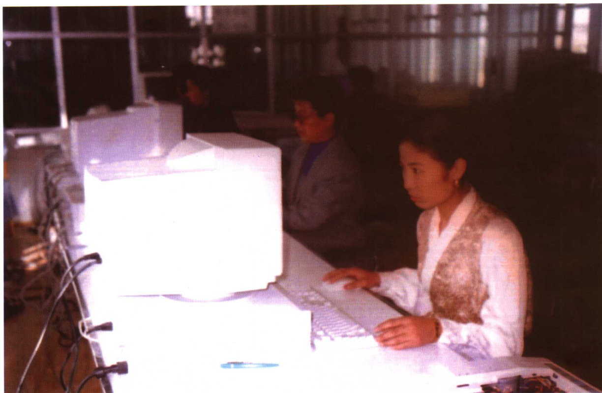
西藏自治区统计局网络核心主控机房。
