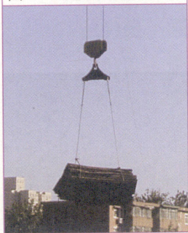
图 1.1-1 起重机起吊重物
