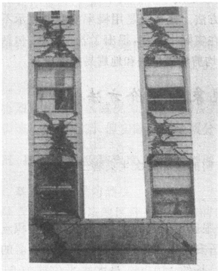
图 1-7 大地震中墙体斜向严重开裂
