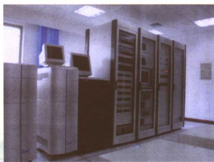
铁路运输调度管理信息系统 (DMIS) (上海分局调度所机房设备)
