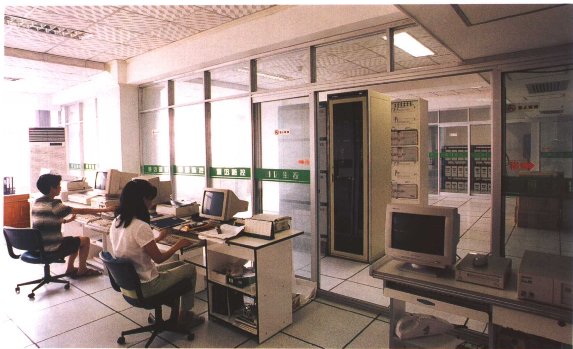
余杭供电局通讯机房
