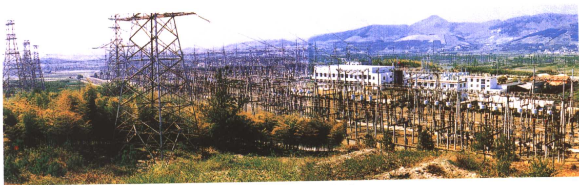
位于余杭瓶窑栲栳山的全省第一座 500 千伏瓶窑变电所
