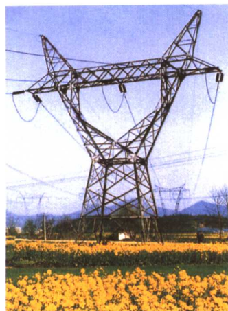
220 千伏输电线路
