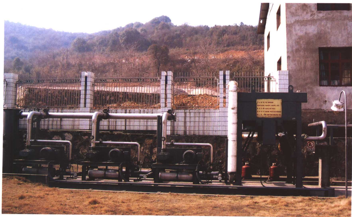
杭州中佳环境技术有限公司一角（天子岭垃圾发电）
