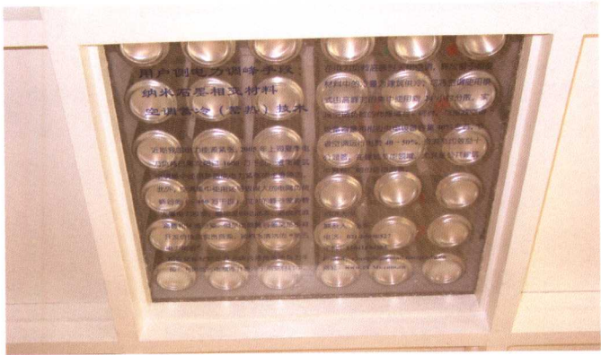
图 0-12 吊顶层内的相变材料蓄能罐
