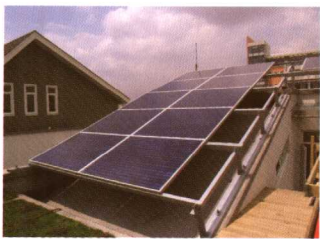
图 0-7 3kW 太阳能 BIPV 系统
