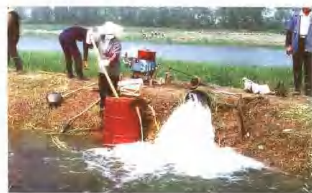
图为邵伯湖灌淤浸灾搬现场。
