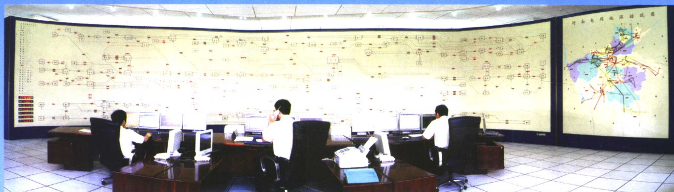
荣获“全国五一劳动奖状”的省公司电网调度室
