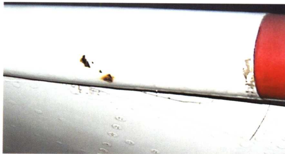
(b) 右平尾配重部位腐蚀穿孔
