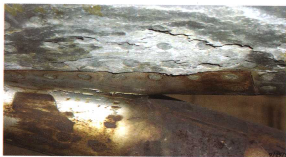
附图2 JX 平尾配重部位发生严重剥蚀
