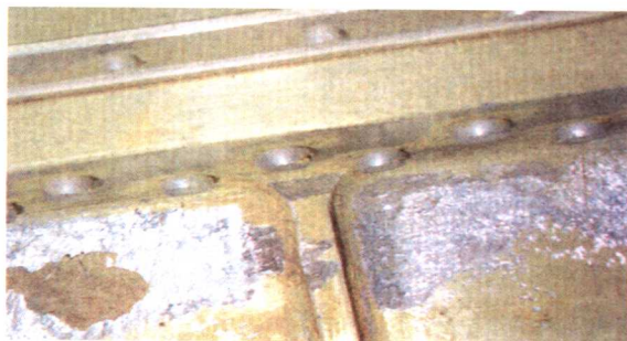
附图5 JY 前梁修理后再次发生大面积腐蚀
