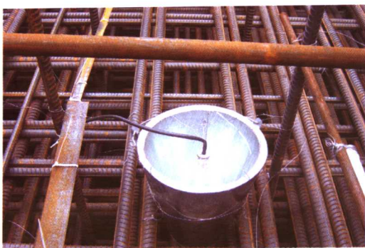
图 51 南主墩承台温控应力应变测试仪器
