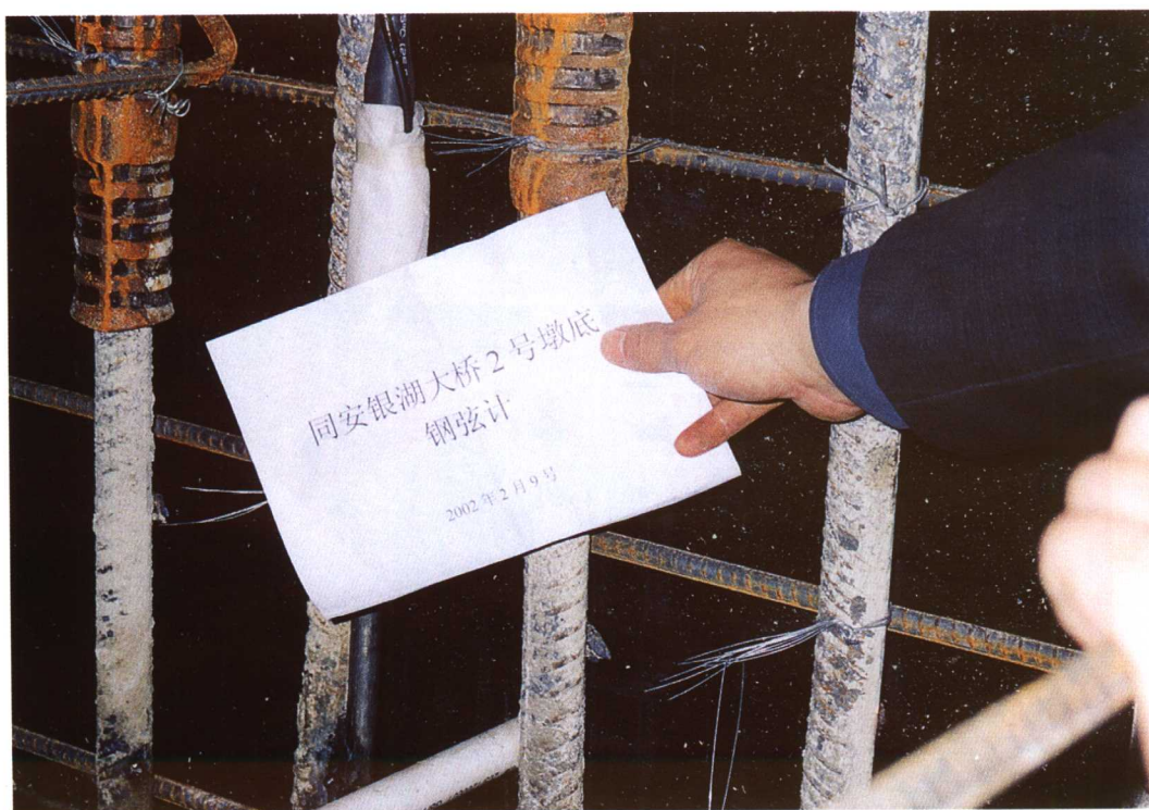
2号墩墩底应力测试钢弦计
