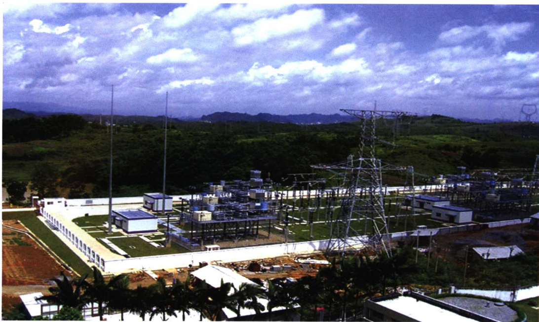
图3 某串补站全景图
