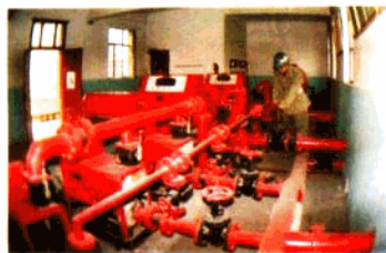
石油公司·自动化灭火设备
