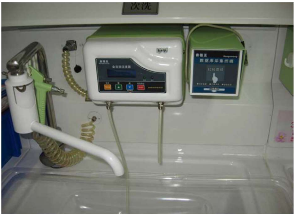
终末漂洗槽（纯水、热水、压力气枪、自动灌流器）
