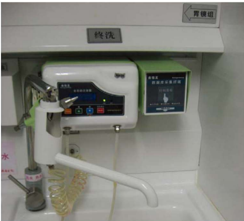
漂洗槽（常水、热水、压力气枪、自动灌流器）
