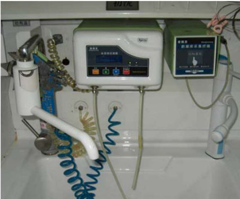
冲洗槽（常水、热水、碱化水、高压水枪、压力气枪、自动灌流器）
