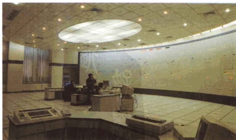
南方互联网中心调度室
