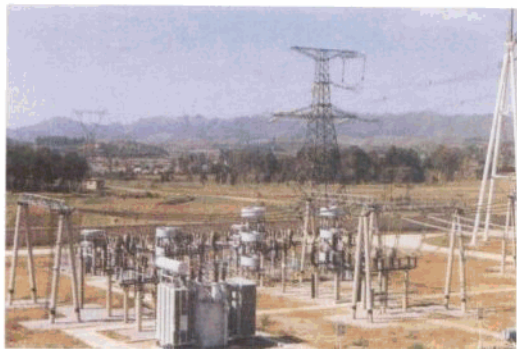
变电容量为 500\text{MVA} 贵阳变电站
