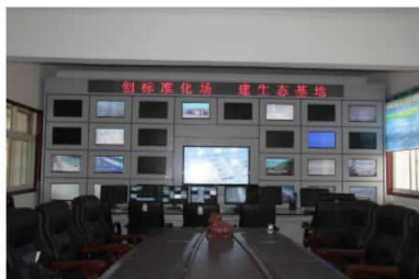
猪场中央控制室
