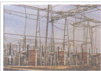
东北输变电设备公司制造的输变电设备。
