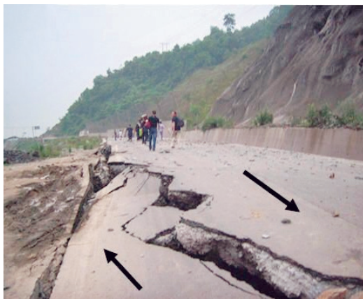
图 1-16 位于断裂带上地震破坏的场景
