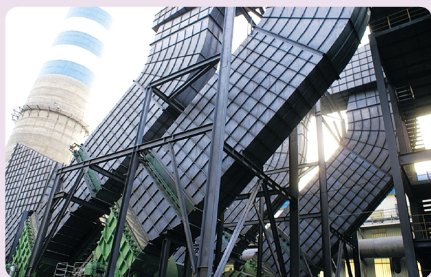
宁夏天元锰业有限公司工业除尘设施
