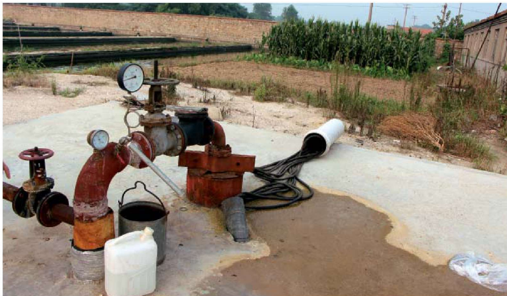
图1-4 地热井（山东威海洪水岚汤地热井，水温70℃）
