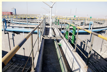
三喜科技企业排污设施
