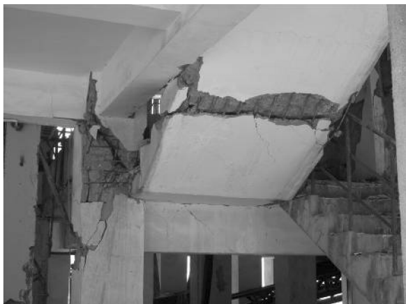
图 1.10 房框结构楼梯毁损
