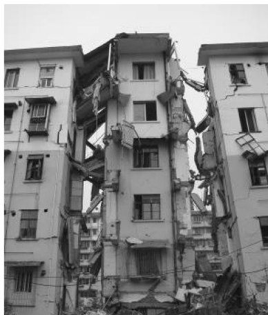
图 1.9 砌体结构损毁
