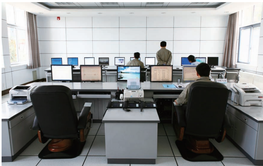
● 电站水库调度自动化中心
