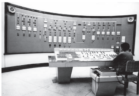
● 电站初期中央控制室
