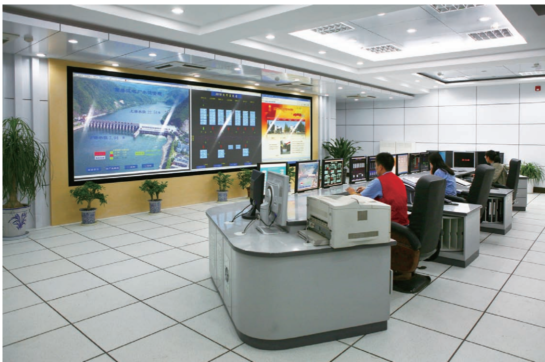
● 电站中央控制室
