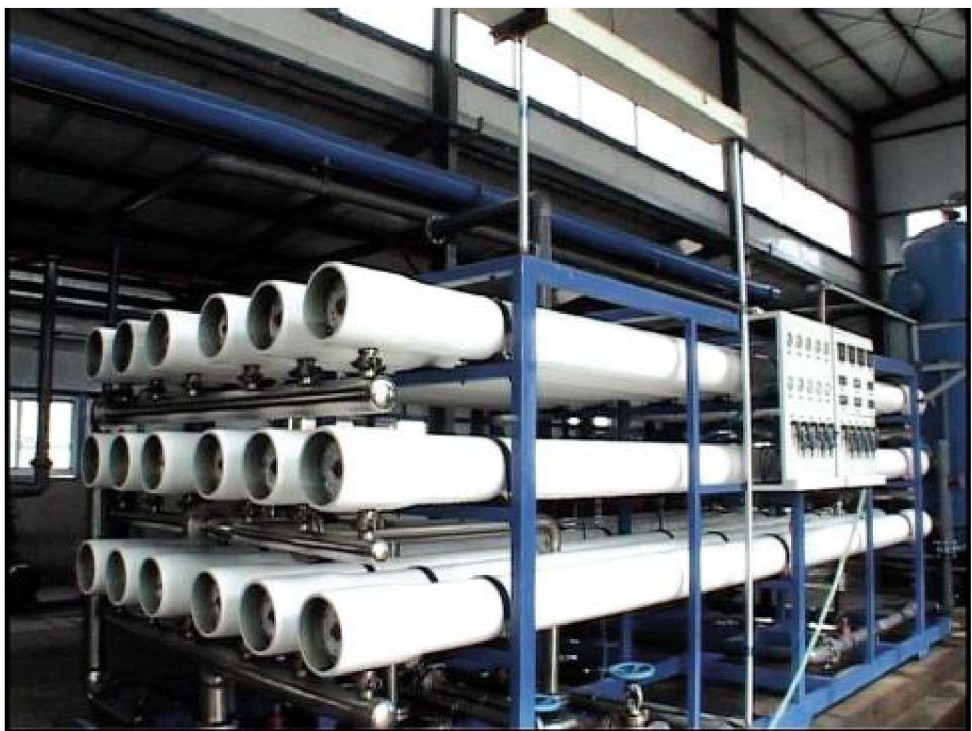
彩图 12 水处理膜过滤系统
