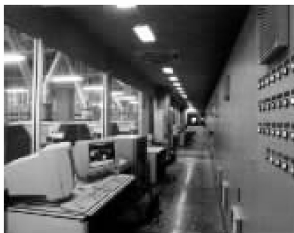
图6 制粉厂的总控制室
