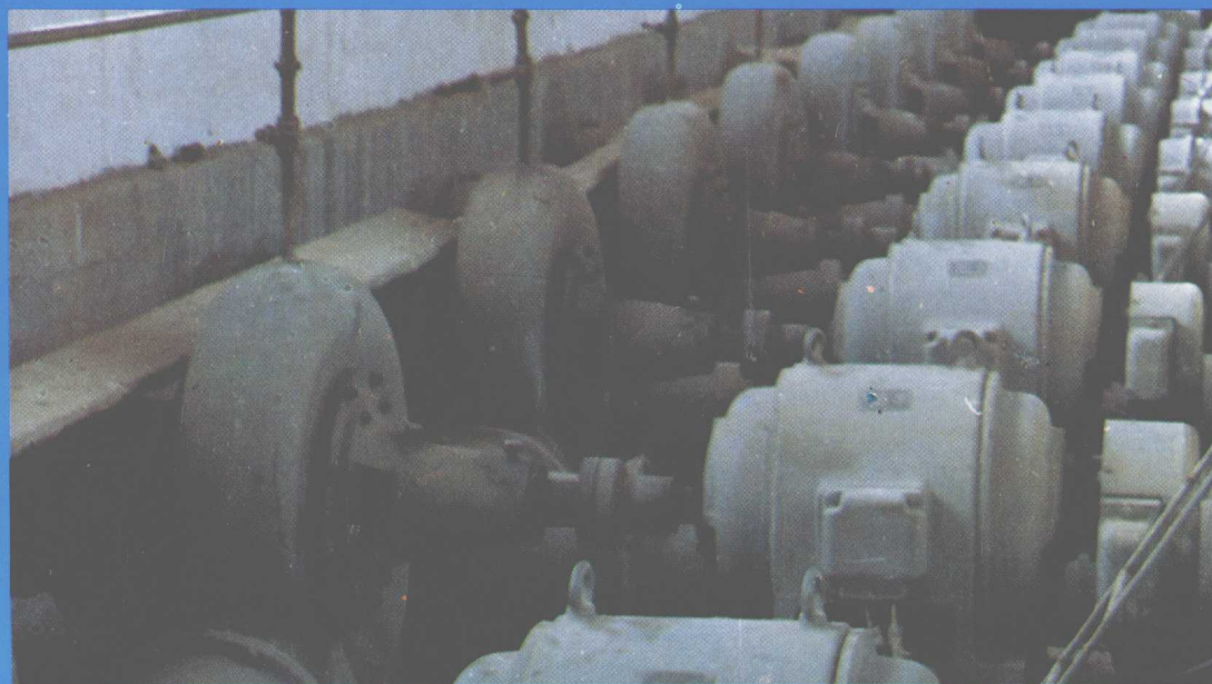
贾村扬水站（机房）
