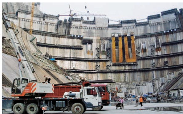
世界第一高坝溪洛渡水电站双曲拱坝
