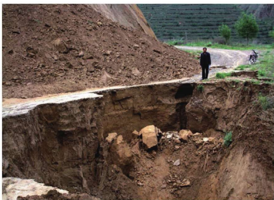
地震造成的路面塌陷
