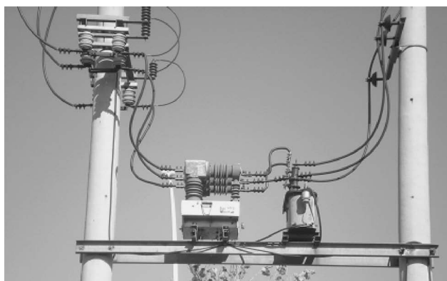
图 1-8 架空线路中的真空断路器
