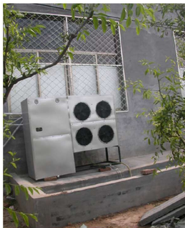
土建装配复合式 100 吨自动冷库 （果园内的厂房改建）
