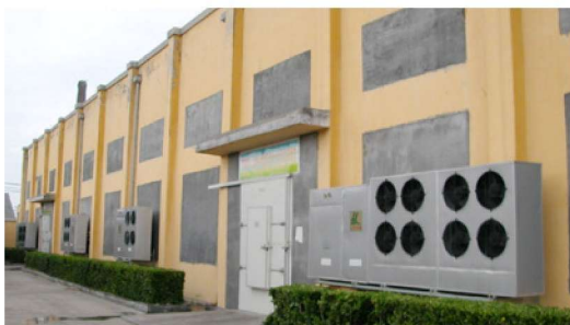
车间改建的多挂机千吨级冷库群
