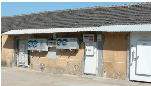
旧仓库改建的多单元挂机自动冷库群
