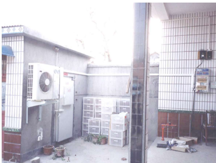
住宅偏房改建的挂机自动冷库
