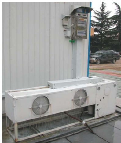
装配式 10 吨自动冷库 （多效冷凝制冷机组运行状态）
