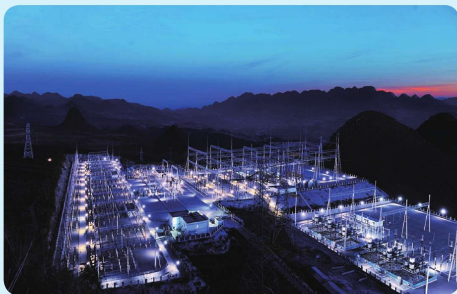
500KV通宝变电站
