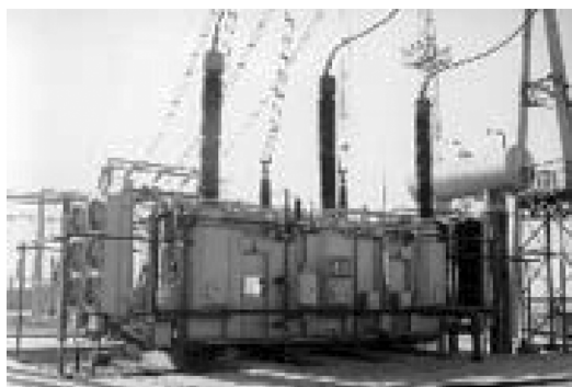
图 1-4 一台运行中的电力变压器
