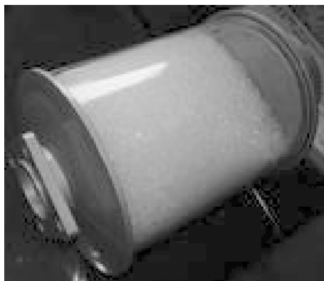
图 1-11 变压器的呼吸器
