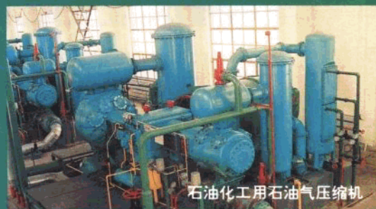
煤气输送用煤气压缩机
