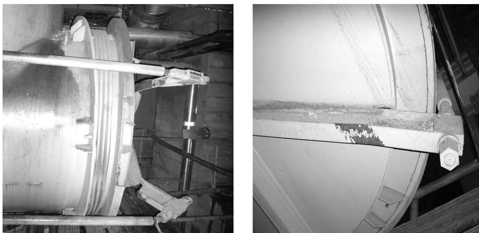
图 1-5 小汽轮机排汽管扩建端膨胀节端盖加强筋两处发生断裂，拉杆严重变形
