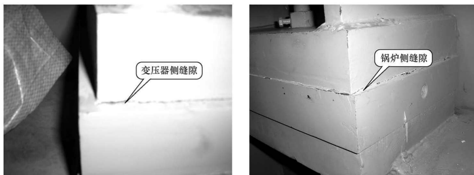
图 1-4 汽缸台板与基础支撑台板之间的缝隙
